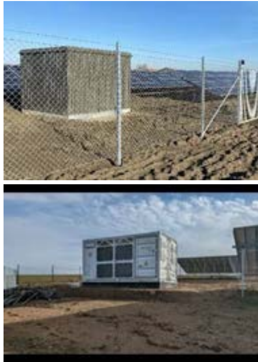
Figur 8. Eksempel på parktransformer.
